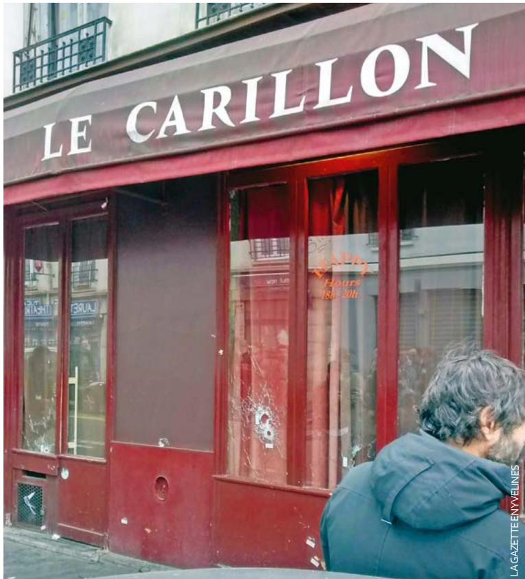
Impacts de balles sur les vitrines du bar, rue Bichat.
